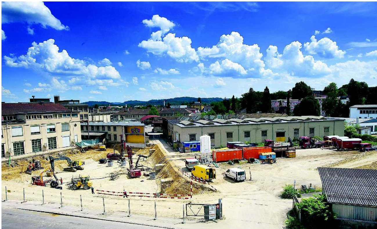
Der erste Neubau im Torfeld Süd wird ein Bürogebäude für die Rockwell Automation AG. EMANUEL FREUDIGER
